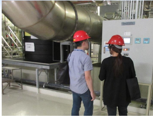
確認污染防制設備運作情形
