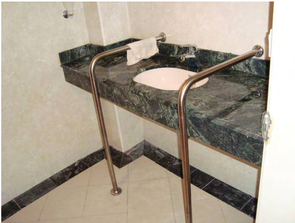
16. 洗面盆扶手設置錯誤。
