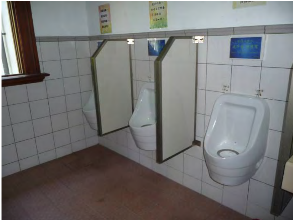
13. 小便器二側及前方未設置扶手。
