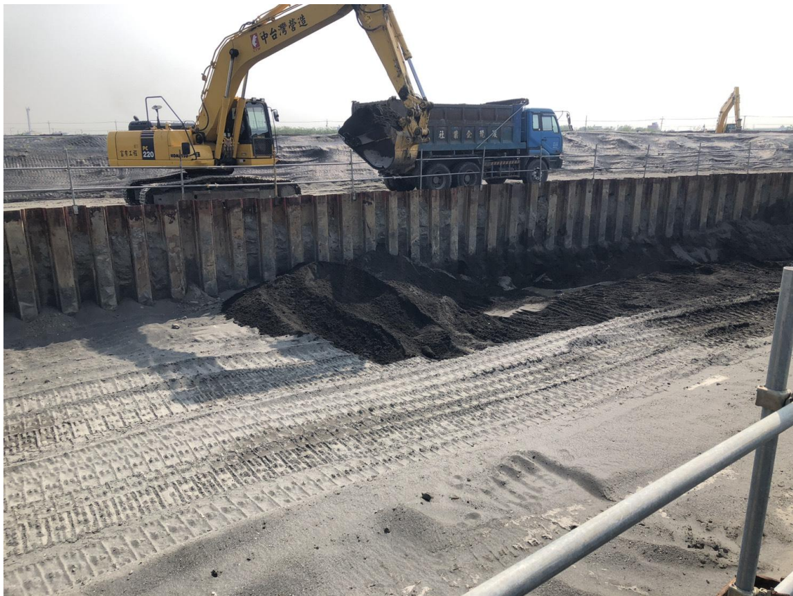
▲主要幹道 60 米道路西段工程, 後續將可銜接 76 線延伸線快速道路
