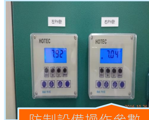
防制設備操作參數 監控儀表
