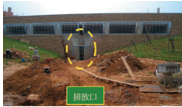
東一滯洪池排放口(重現期1年)
