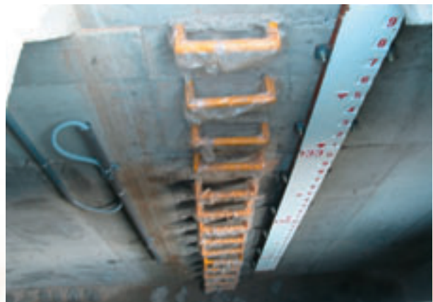
滯洪池水位監測系統
