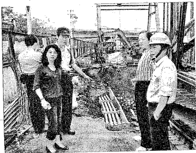
▲中科汙水排放管工程，施工單位不慎扯斷中華電信電纜線，民代吳瓊華等人前往關心。（吳進昌攝）
