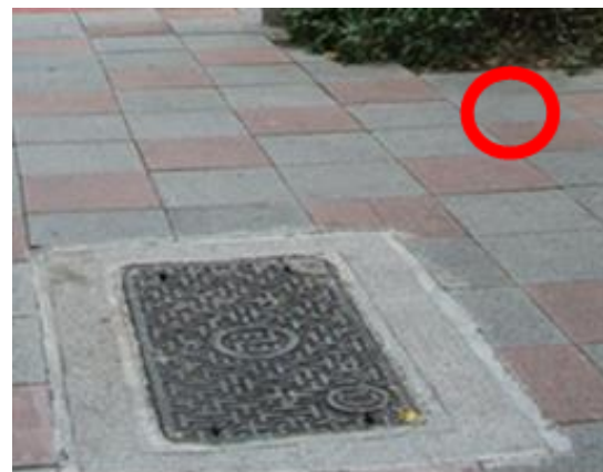
通路地面人孔蓋應平整
