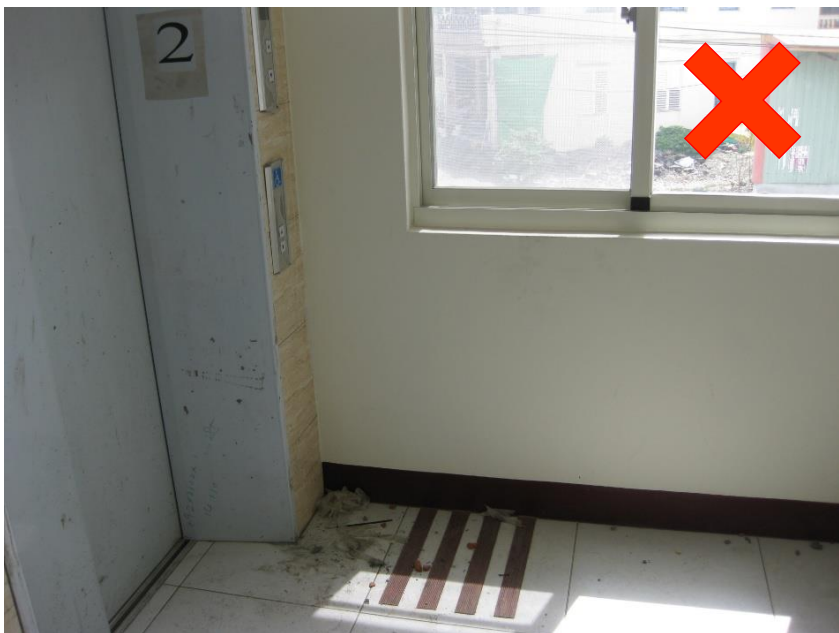
呼叫鈕前空間不足輪椅使用者不易觸及呼叫鈕
