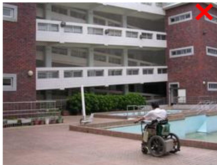
坡道連接樓層高差超過3公尺， 中間未設置平台
