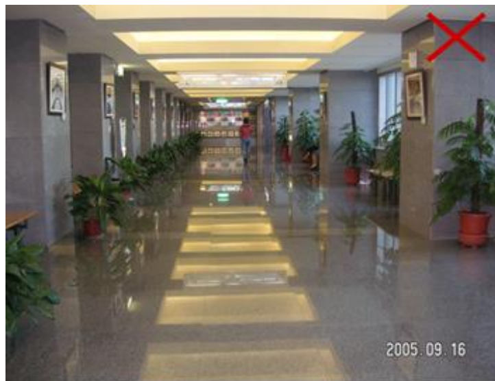
通路地面過於光滑，潮濕時，防滑性能 不佳，易造成輪椅打滑及滑倒
