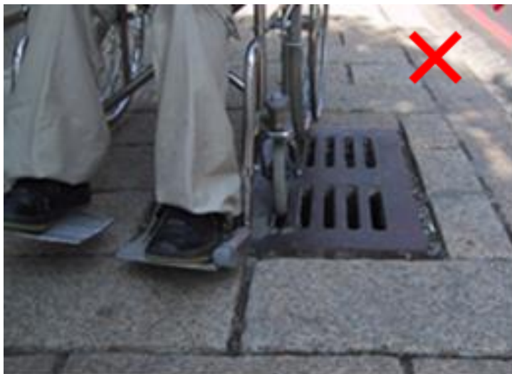
溝蓋開口過大，造成輪椅前輪陷入
