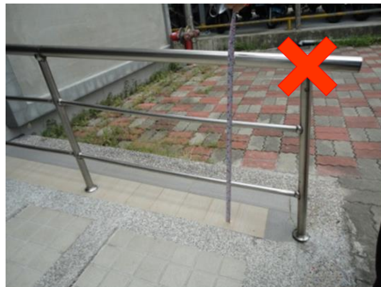
扶手端部未做防勾撞處理視障者易撞擊突出物
