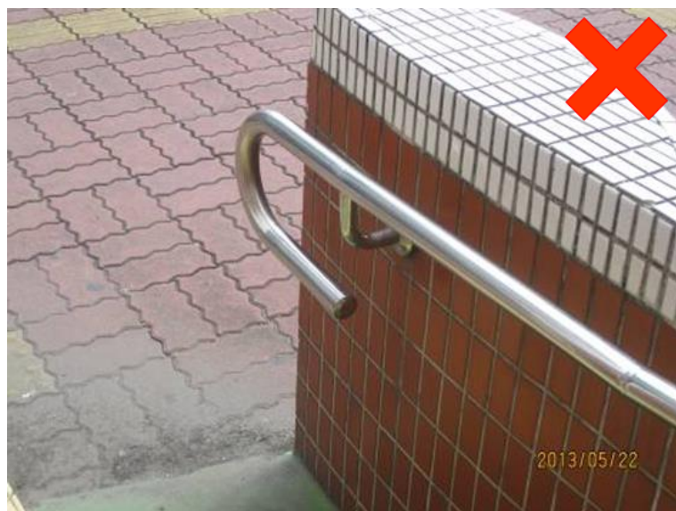
扶手端部未做防勾撞處理易勾住衣物
