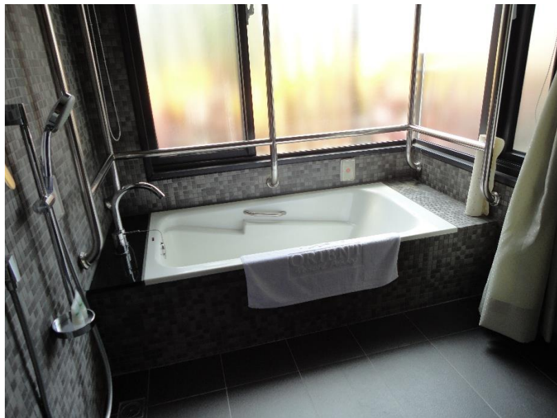
浴缸設有固定式轉位台方便輪椅使用者移位
