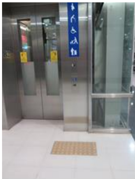
昇降機引導設施設置案例
