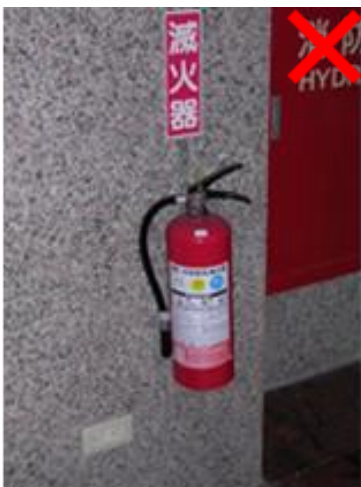
滅火器懸空突出牆壁10公分以上
