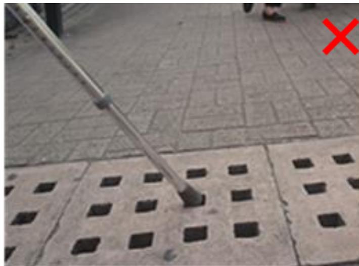
溝蓋開口過大，造成白杖陷入
