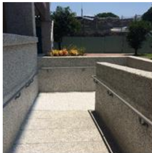
無障礙坡道應考慮輪椅使用者迴轉時操作所需之空間直徑為150公分
