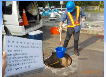
納管水匯流井
