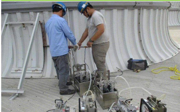
冷卻水塔採樣情形
