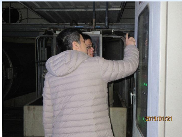
確認污染防制設備運作情形
