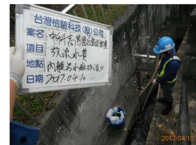
內轆污水廠放流口
