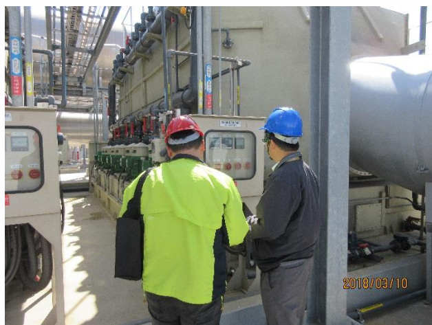
確認污染防制設備操作參數
