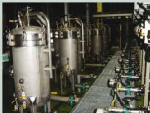
中科廠N-1設計之Filter過濾器
