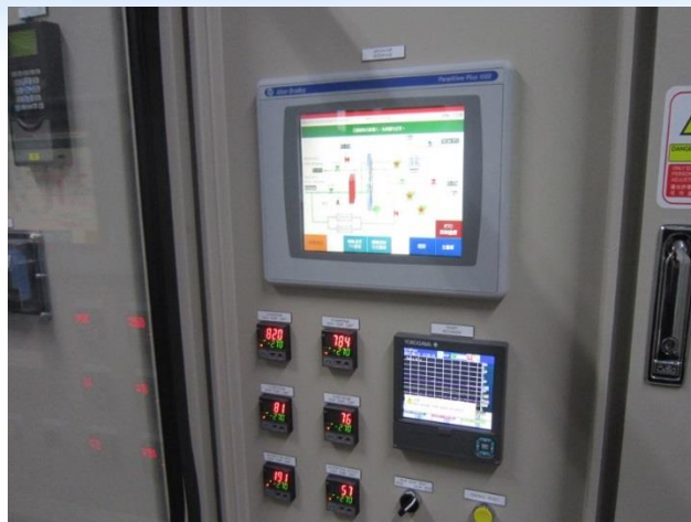
確認污染防治設備運作情形
